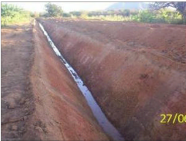
Esta foto ilustra um dreno coletor aberto.
